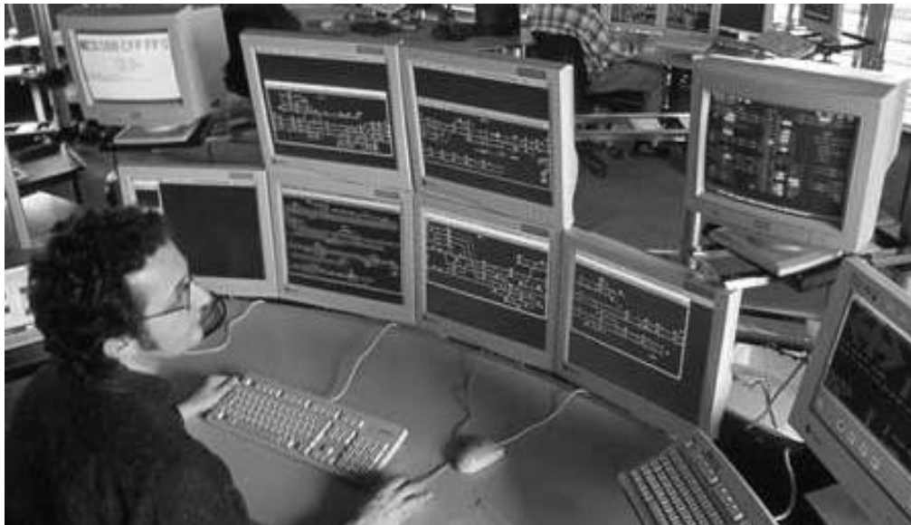
Pusat Kontrol Kereta Api di Stasiun Luzern, canggih dan akurat.
